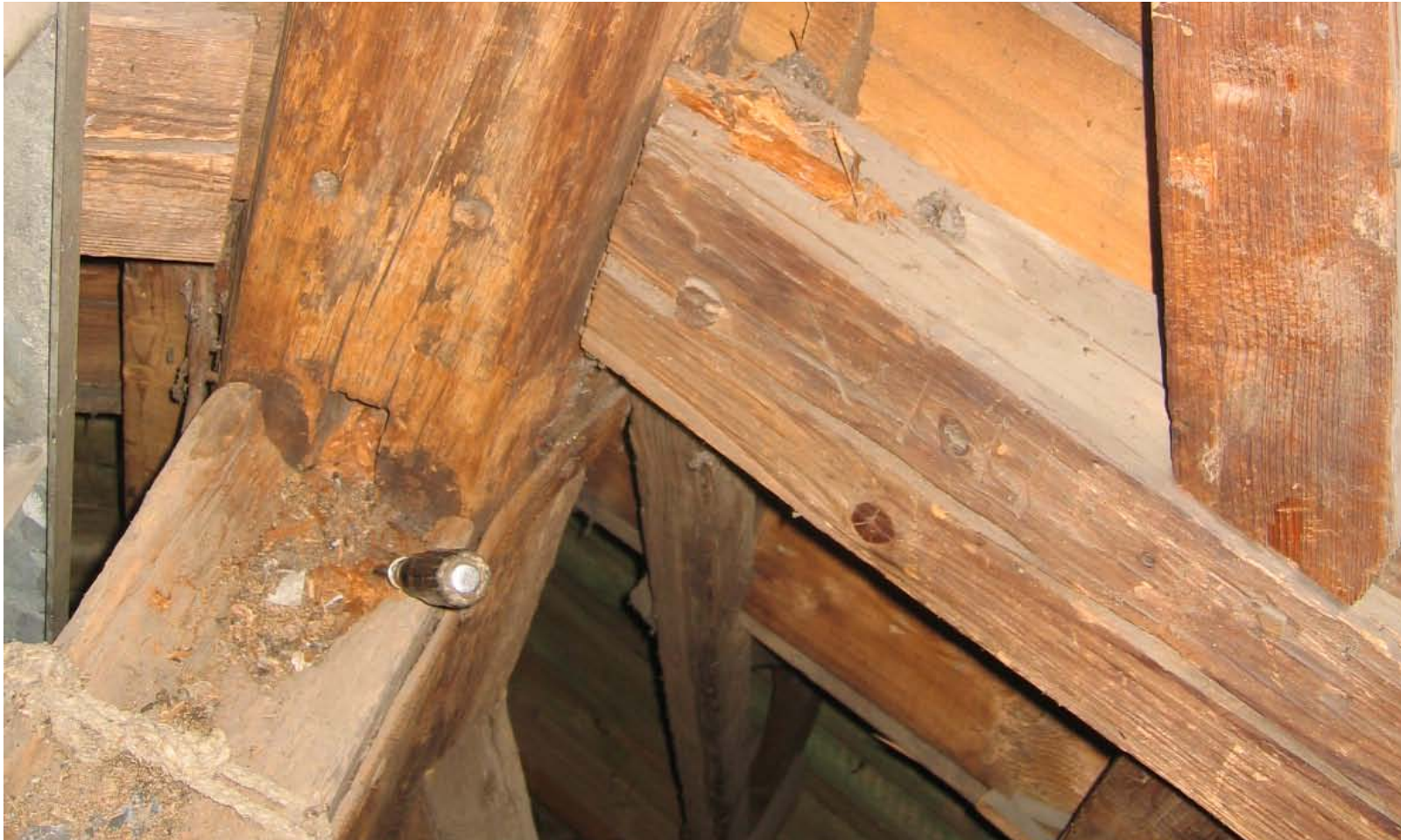
Turmhaube, zerstörte Holzverbindungen
