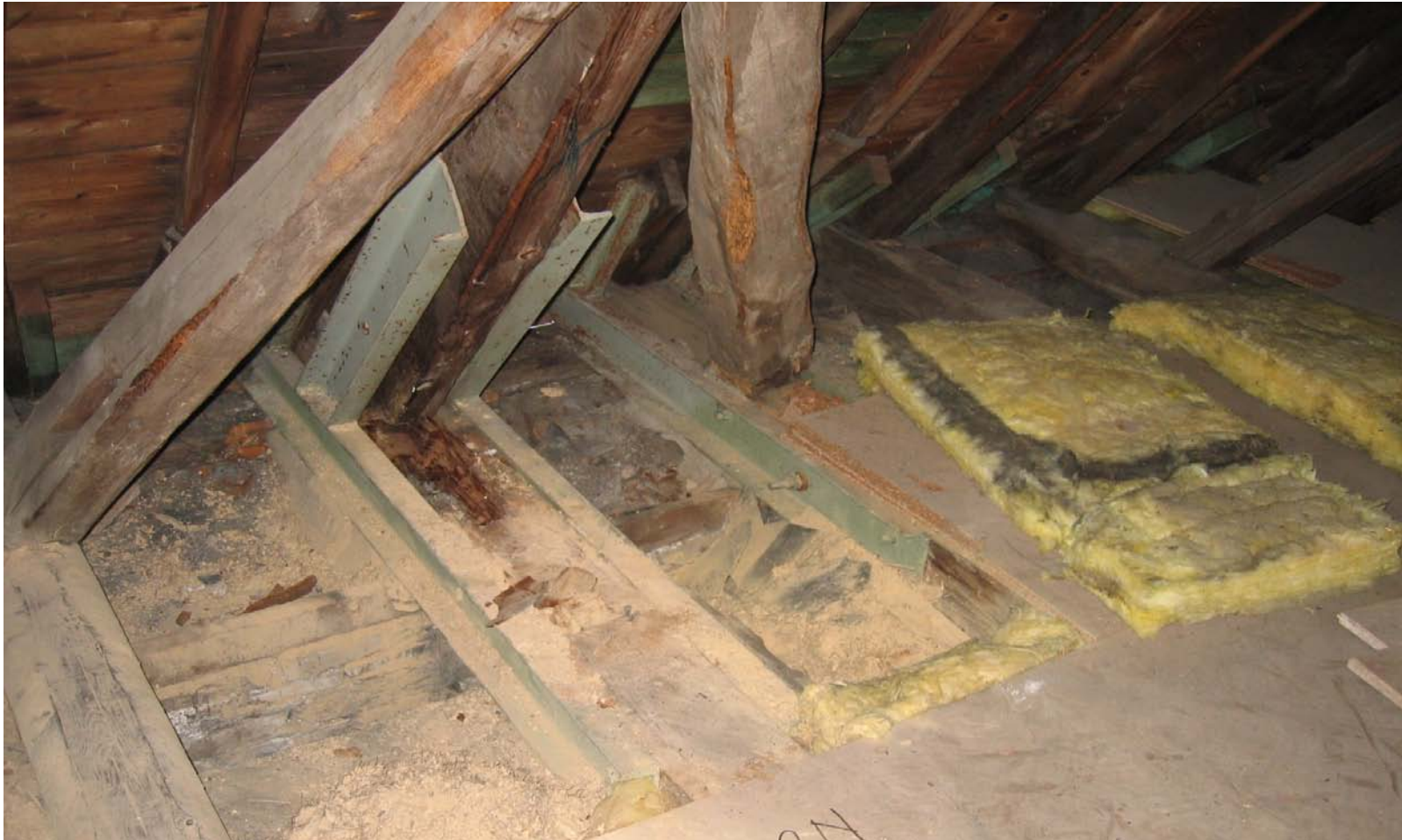
Deckenbalken, Sparrenfüße, Mauerkrone, Stuckkehle Befallsbereich durch Echten Hausschwamm, mangelhafte Instandsetzung
