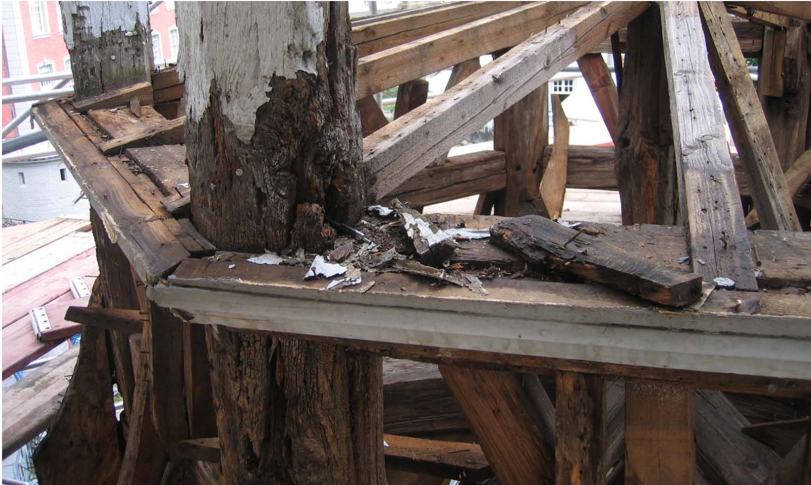
Bau begleitende Begutachtung, Laternenständer Innenfäule
