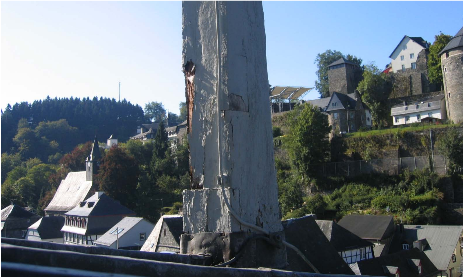
Laternenboden und Laternenständerfuß Innenholzerstörung, baulicher Holzschutz nicht beachtet
