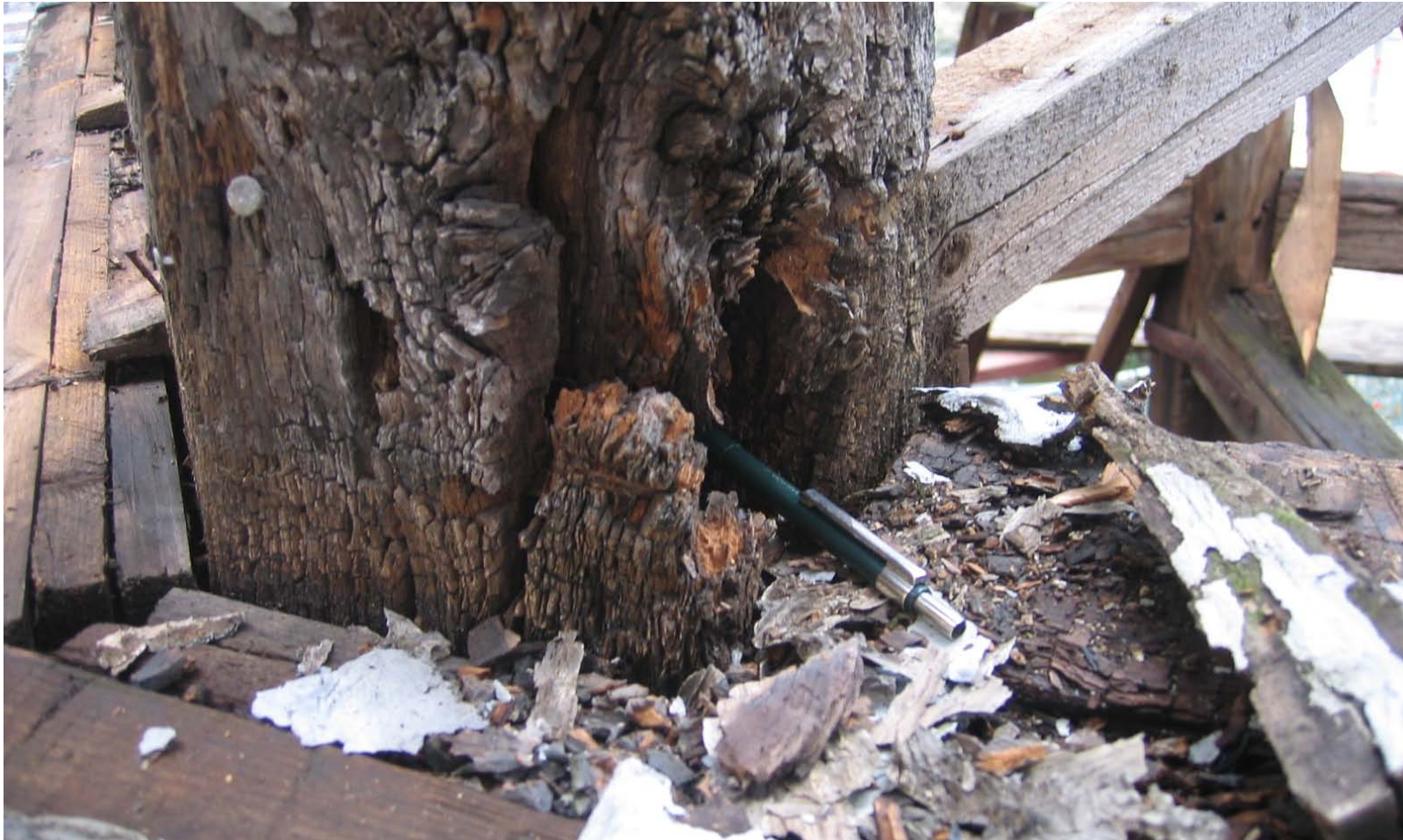
Bau begleitende Begutachtung, Laternenständer Innenfäule
