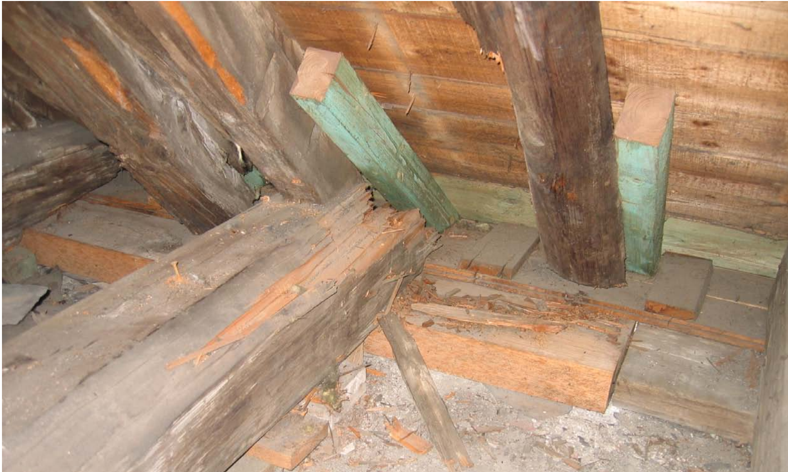
Balkenkopf und Sparrenfuß, mangelhafte Instandsetzung
