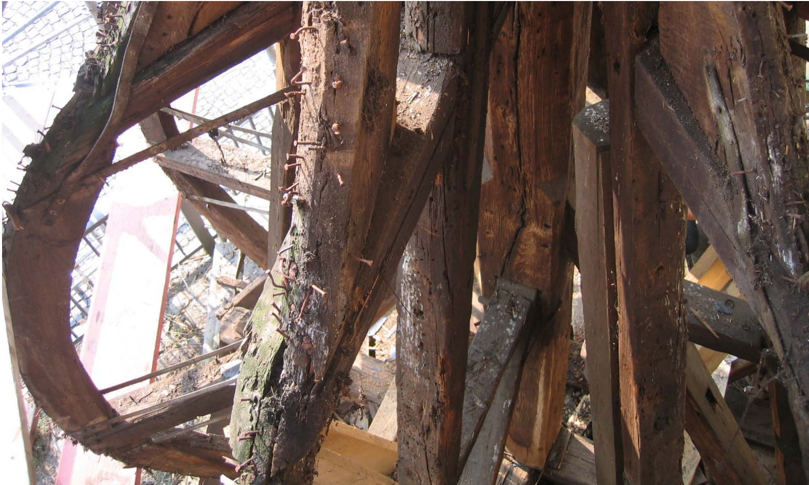
Bau begleitende Begutachtung, Helm, Schäden an Schablonen
