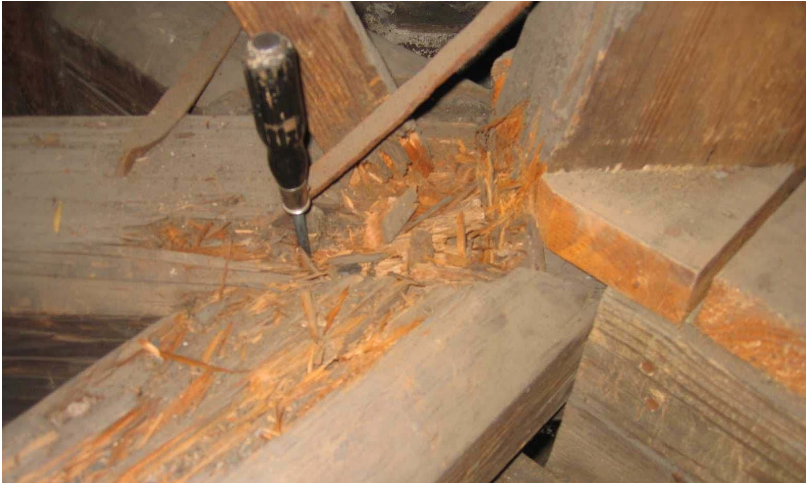
Turmhaube, Ebene 1, Balkenstern, Innenfäule
