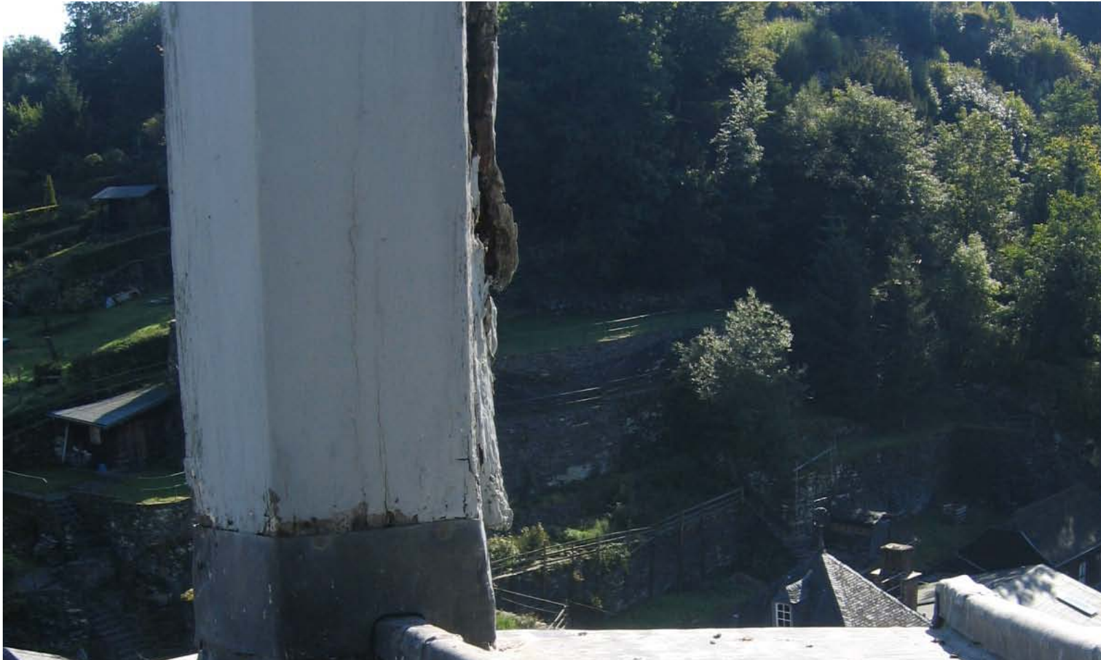
Laternenständerfuß Innenholzerstörung, baulicher Holzschutz nicht beachtet
