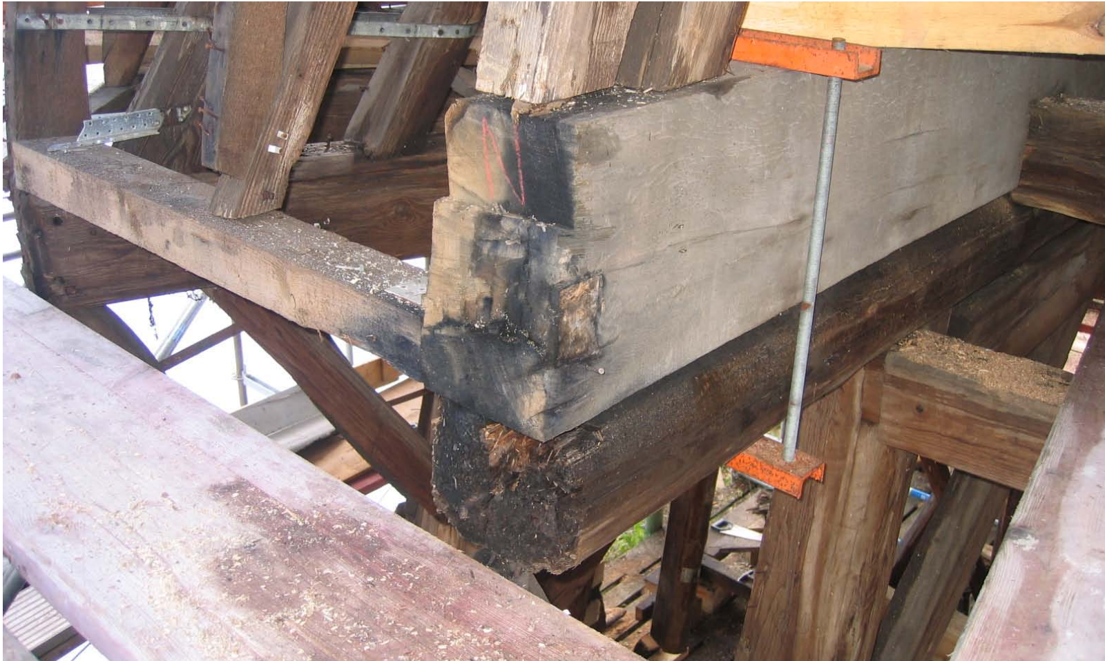
Bau begleitende Begutachtung, Balkenstern, Ebene 2 Innenfäule durch Blättlinge
