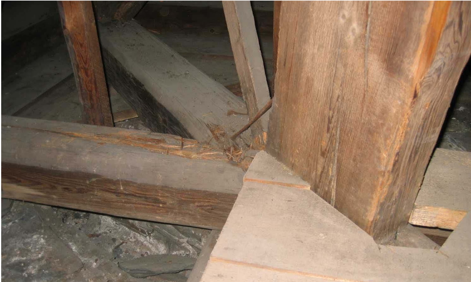
Turmhaube, Ebene 1, Balkenstern, Innenfäule
