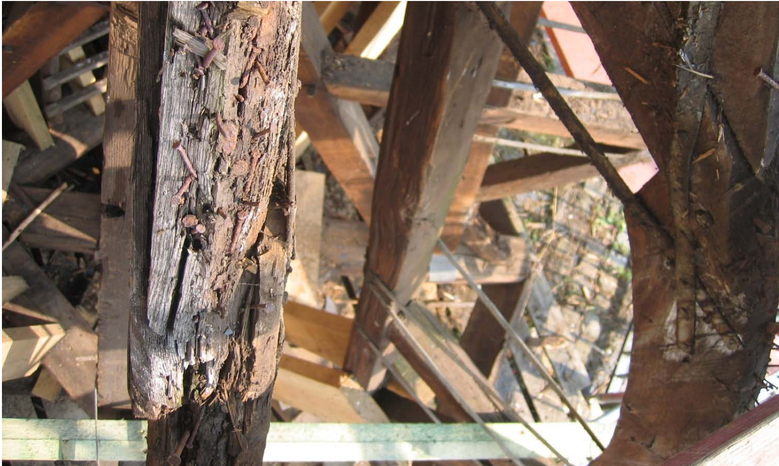
Bau begleitende Begutachtung, Helm, Schäden an Schablonen
