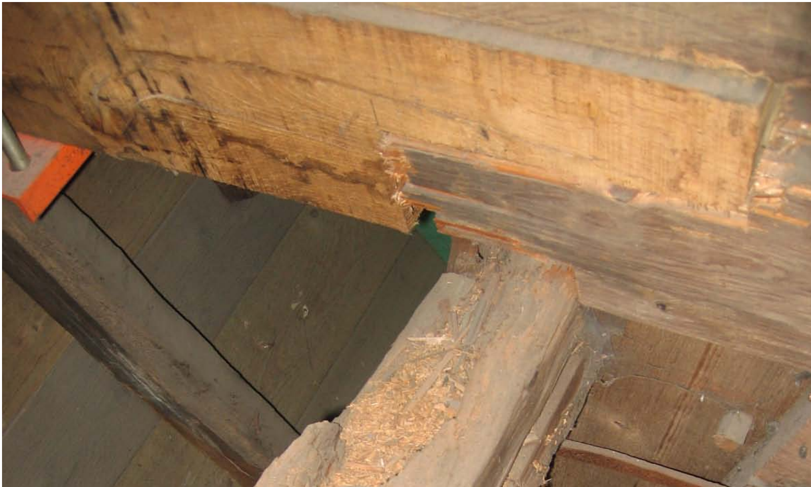
Turmhaube, Ebene 2, mangelhafte Instandsetzung
