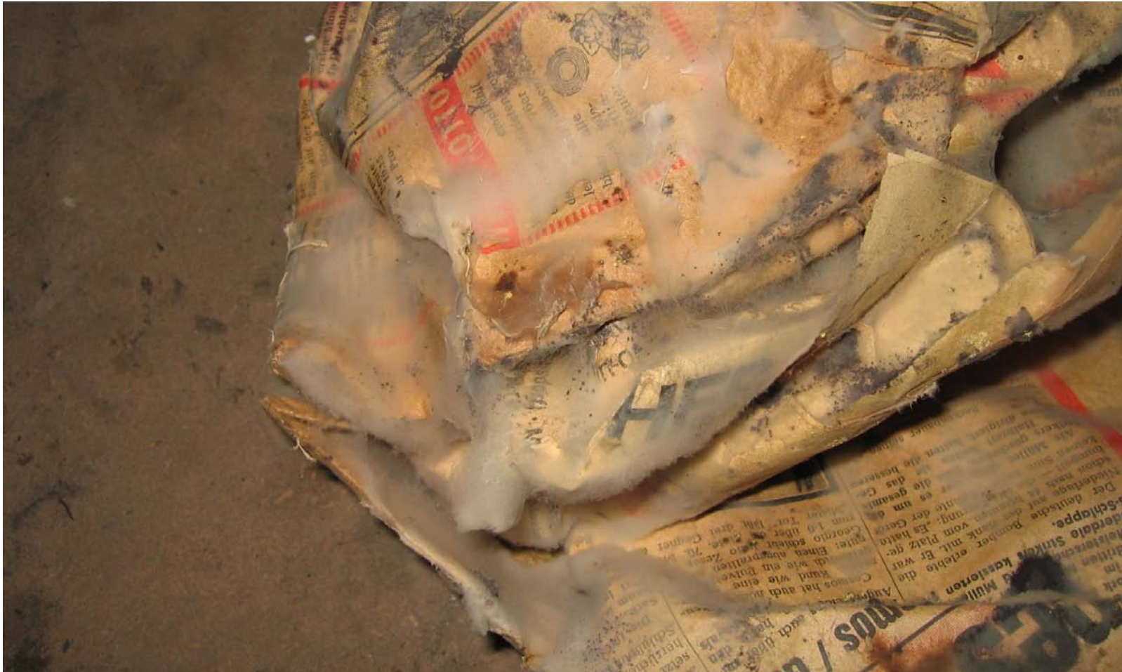
Schutt und Schmutzablagerungen in der Stuckkehle, Luftmyzel
