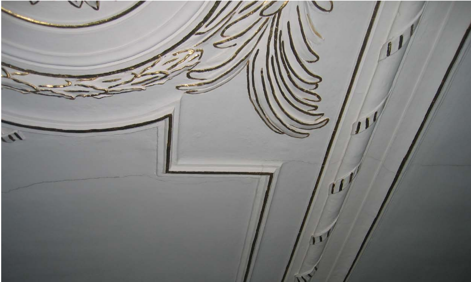
Deckenuntersicht, Rissbildung im Verlauf der Deckenbalken
