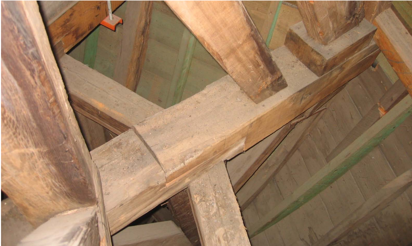
Turmhaube, Ebene 2, mangelhafte Instandsetzung
