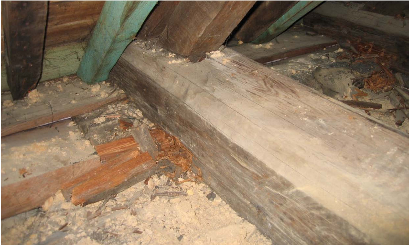
Balkenkopf und Mauerlatte, mangelhafte Instandsetzung
