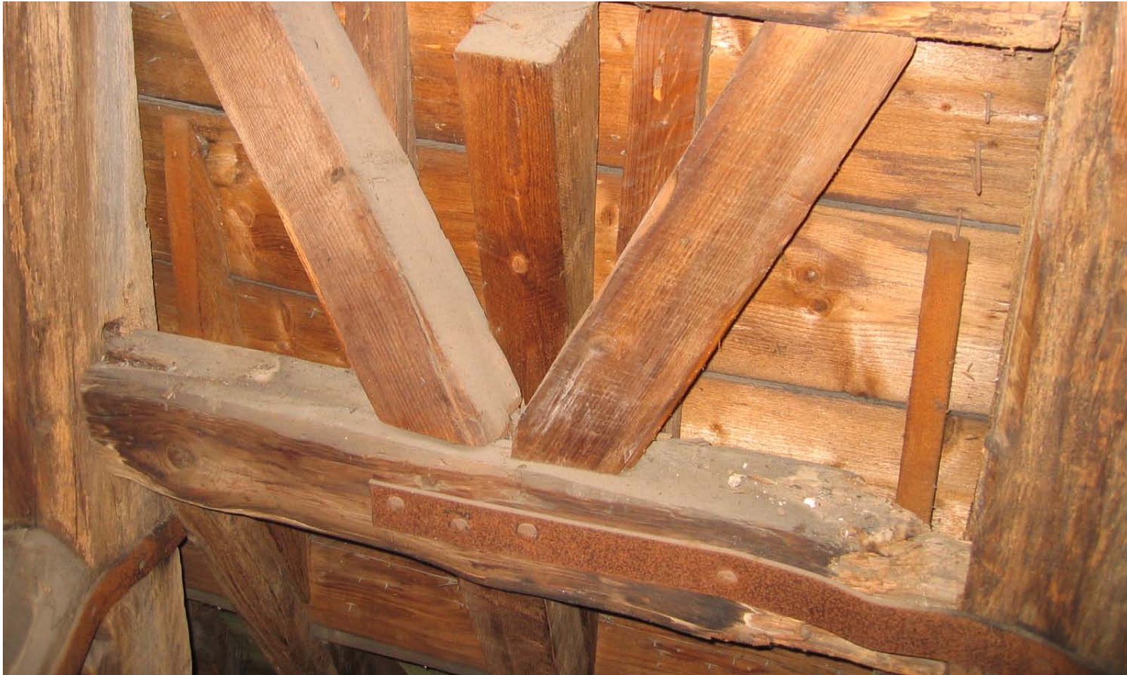
Turmhaube, zerstörte Holzverbindungen
