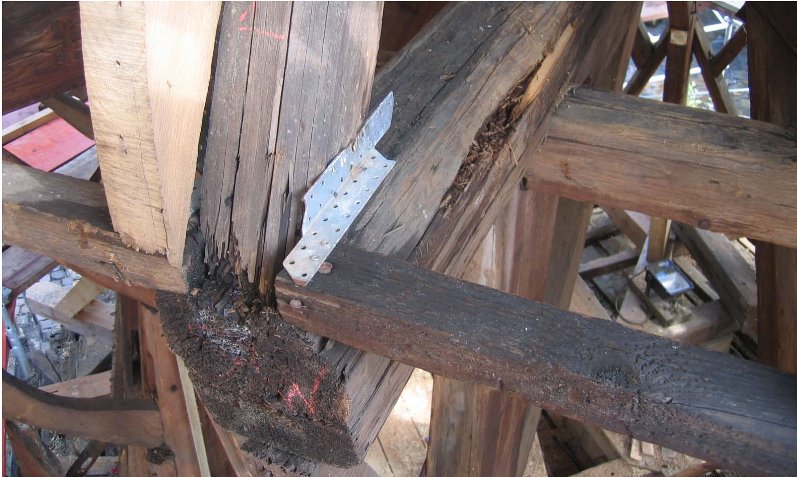
Bau begleitende Begutachtung, Turmhaube, Ebene 2 Innenfäule durch Blättlinge
